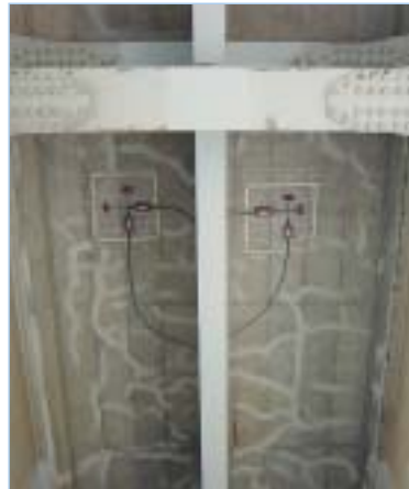
Capteurs optiques installés en croix pour mesurer les contraintes dans les 2 directions
