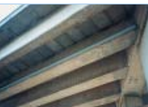
Corde optique protégée sur poutre sous le tablier
