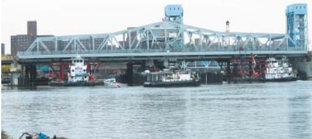
La liaison à quatre voies qui relie Harlem au Bronx est surveillée par des cordes optiques de 2 à 5 m
