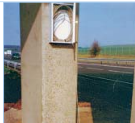
Connecteurs optiques en attente, protégés par un boîtier
