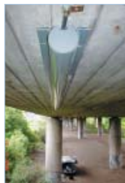
Corde Optique protégée en sous-face d'une travée
