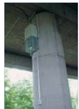
Station de monitoring reliée à Internet
