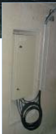
Coffret de connexion pour mesures périodiques
