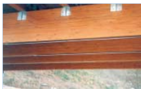
2 cordes optiques 5m sur les poutres principales
