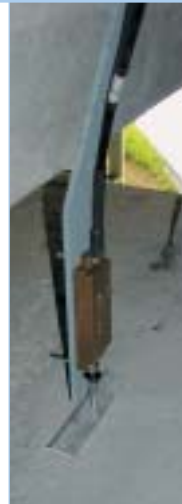
Un des 2 capteurs OSMOS/WIMS installés sur le pont
