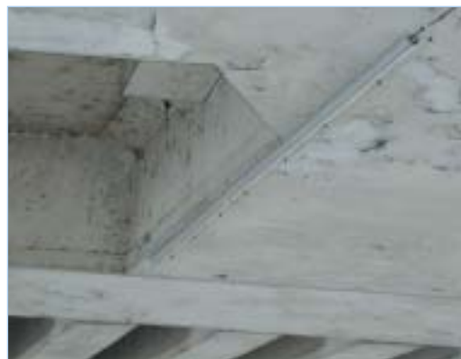
Corde Optique de 5m en sous-face du pont
