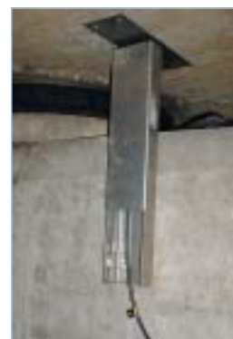
Un des capteurs WIMS installés sur l'ouvrage
