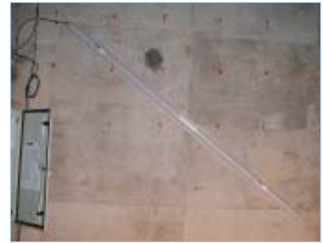
Mesure des efforts tranchants à l'intérieur d'un voussoir
