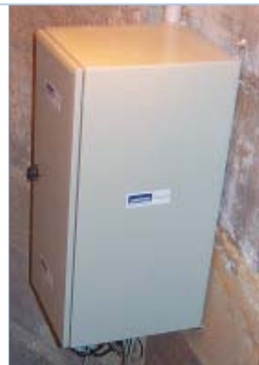
Station de monitoring reliée à Internet
