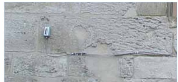
Inclinomètre et sonde thermique
