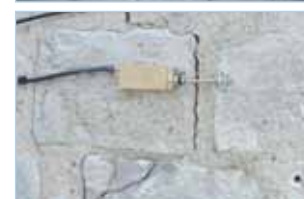
Extensomètre optique sur fissuration verticale, détail
