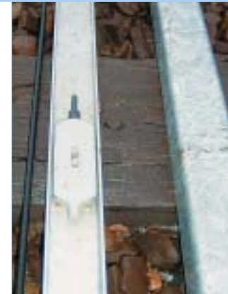
Corde optique montée sur support métallique avant capotage de protection
