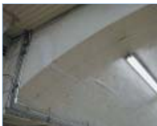
Corde optique avant capotage sous une des voies
