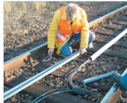
Les câbles de liaison optique sont acheminés vers la station de monitoring
